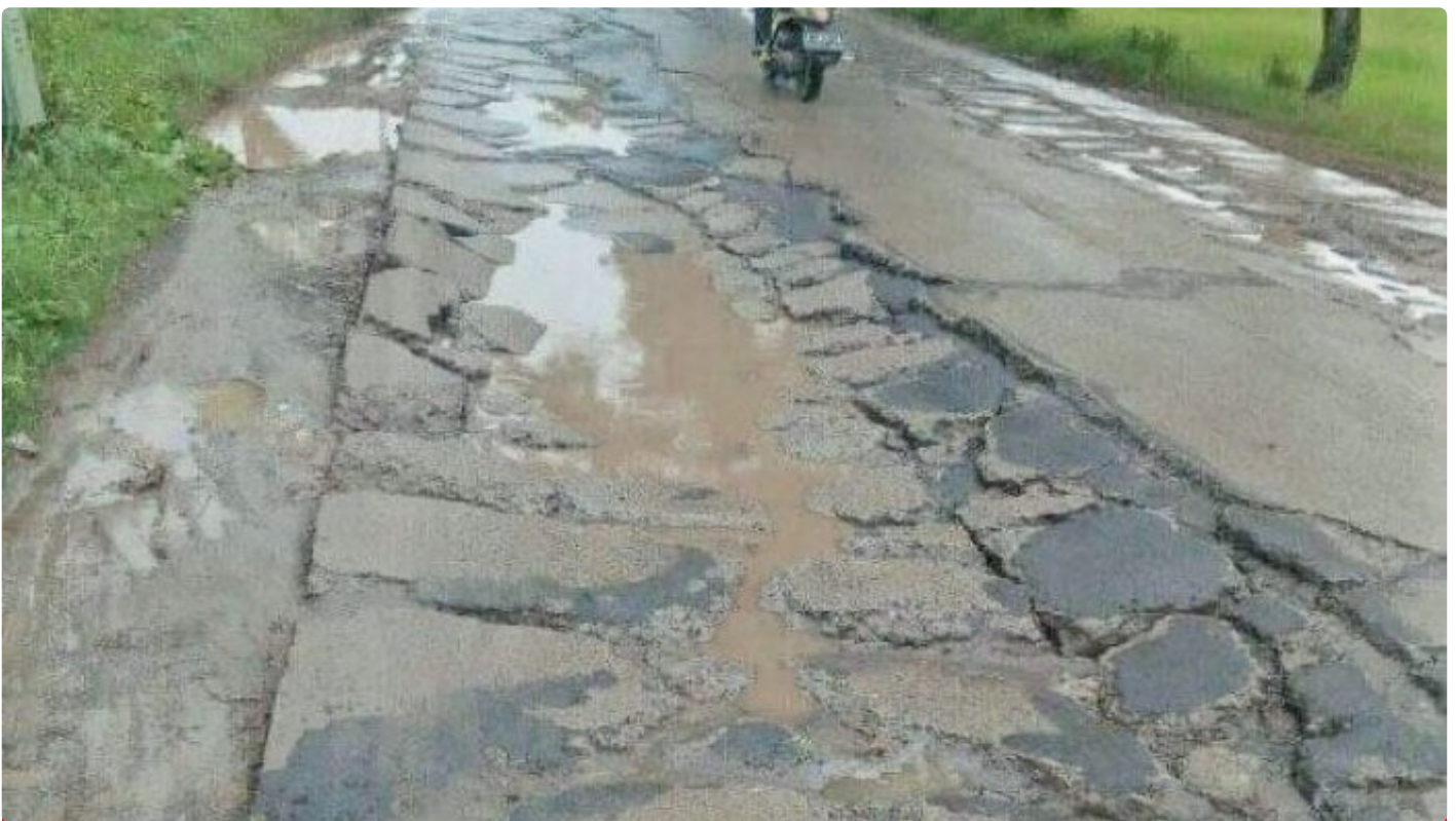
Jalan Beyeh-Simpang yang sudah sangat rusak parah
