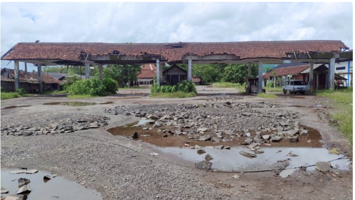
Kondisi memprihatinkan Terminal Simpang Malingping
